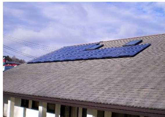
グリーン電力証書で設置された太陽光発電
